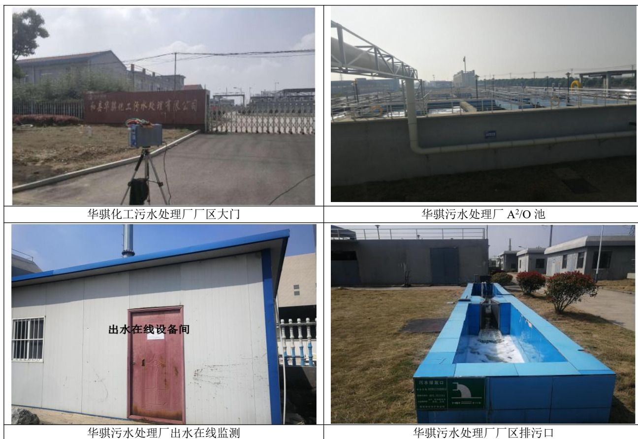
图 7.2.1-2 华骐污水处理厂现场图
